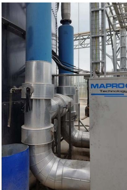
Fig. 12 – giunti antivibranti e incapsulamento tubazioni
